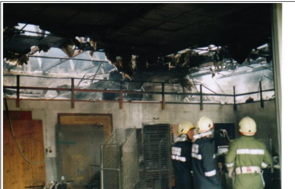
Am 19. Oktober kam es in der Druckerei Wührer im Gewerbegebiet durch einen technischen Defekt zu einem neuerlichen Schwelbrand. Durch die große Hitze und den Ruß entstand wiederum großer Sachschaden.
